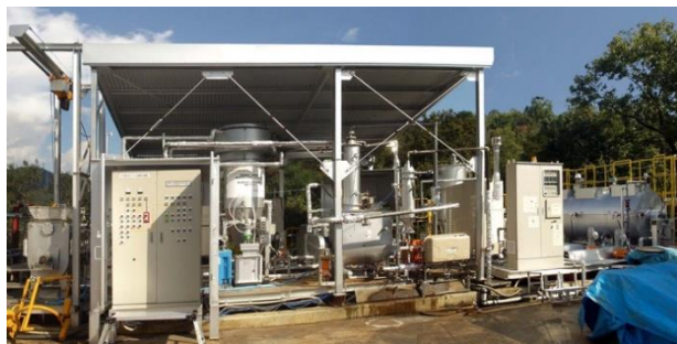
写真1 脱水汚泥の乾式メタン発酵プラント
